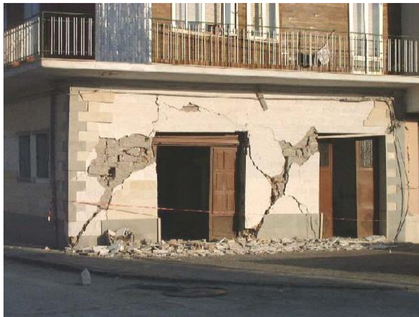
Fig. 1.1.2. Rotture a Taglio per fessurazione diagonale [2]
