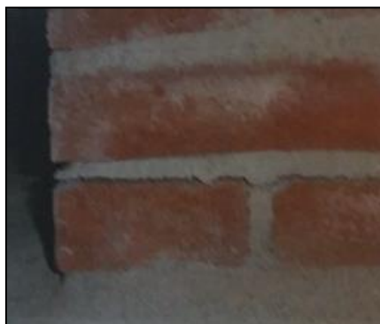
Figura 97. Distacco tra malta e laterizio per effetto della trazione [3]
